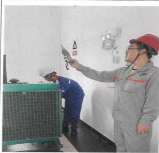
2025.10.14 发电机房噪声检测
